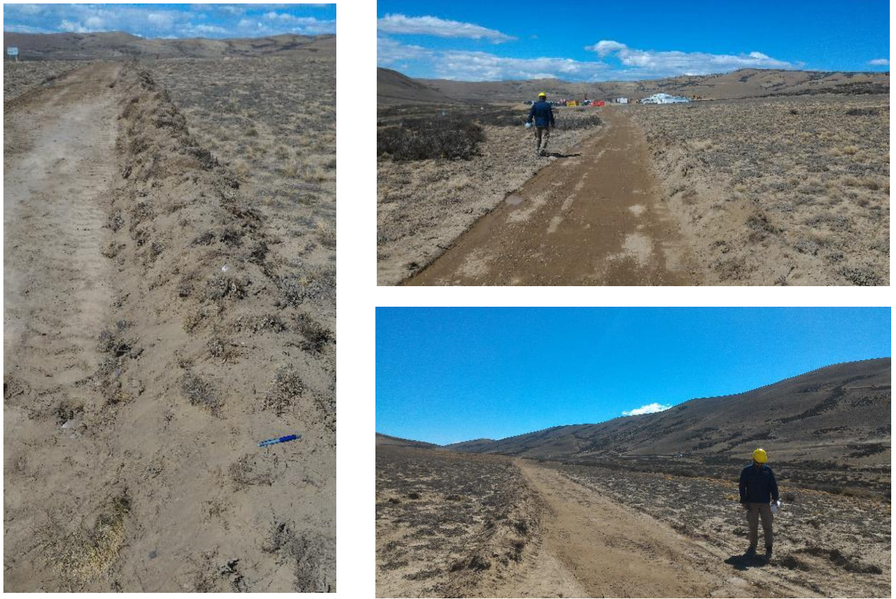
Figura 9-65. Vistas de movimientos de suelo realizado sin relevamiento previo. Sector Villa NK. Febrero 2017.
